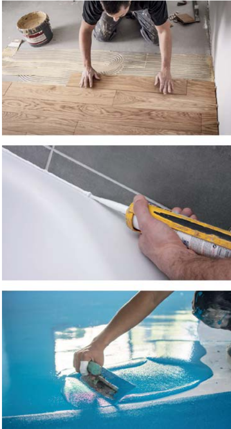
Abb. 7 Chemikalien in Baustoffen können negative Auswirkungen auf die Gesundheit der Verarbeitenden haben.
