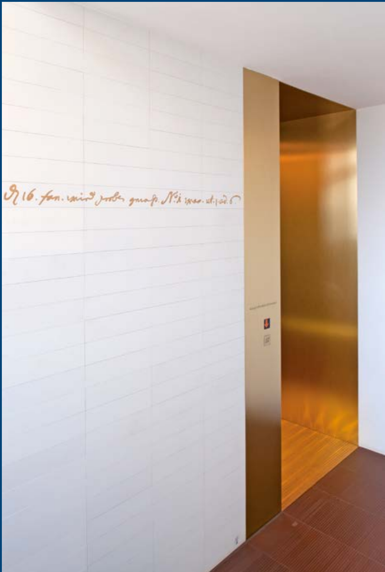
/Integration eines Aufzuges in die komplexe Geometrie einer mittelalterlichen Burgranlage Besucheraufzug in der Albrechtsburg zu Meißen (DD1 Architekten)
