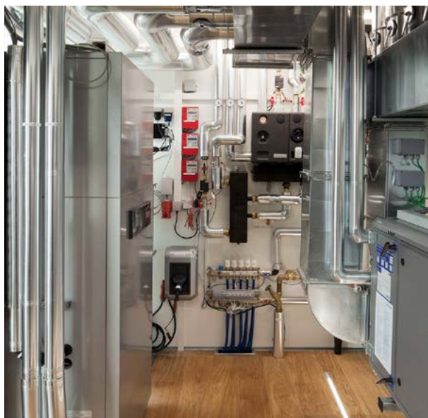
Blick in den Technikraum
